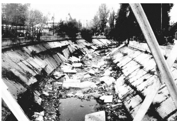
Рис. 8. Разрушение облицовки стабилизированного русла р. Есентай. Фото А.Х. Хайдарова
